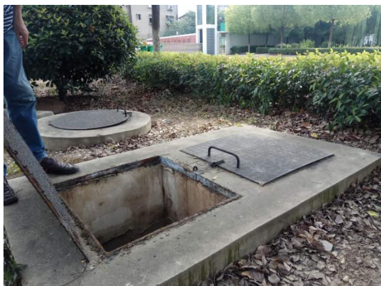
一体化处理装置进口
